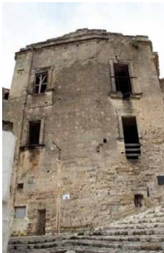
Un prospetto inquietante di Palazzo Zicari, abbandonato nell'incertezza. Il tetto ormai distrutto dagli agenti atmosferici è pericoloso come il resto della struttura
