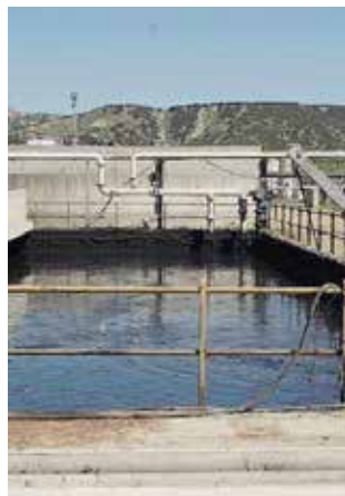
CONTENITORI Una delle vasche dell'impianto
