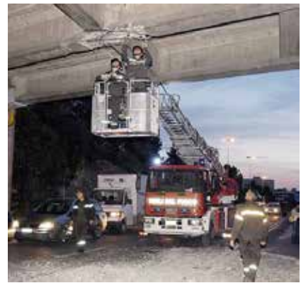
IL PONTE DANNEGGIATO L'evento dei vigili del fuoco [foto Genovesi]
