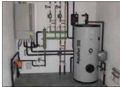
L'interno di un vano caldaia
