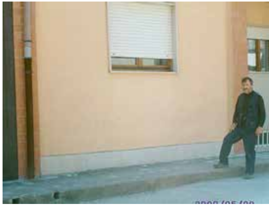
IL MARCIAPIEDE INCRIMINATO La casa di via Melfi e il figlio Nicola dei due anziani
