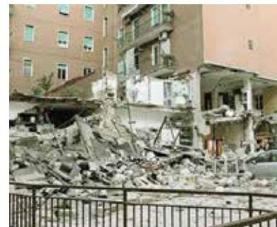
DOPO L'ESPLOSIONE Il crollo a Foggia, via De Amicis (foto Maizil)
